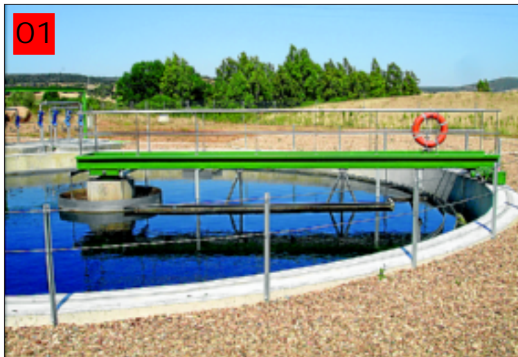
P Estación Depuradora de Aguas Residuales de Alange.
