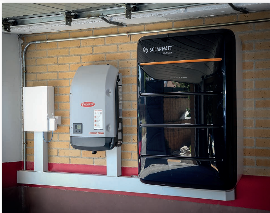
Instalación solar fotovoltaica sobre tejado residencial (arriba) Batería para almacenamiento de la instalación (abajo)
